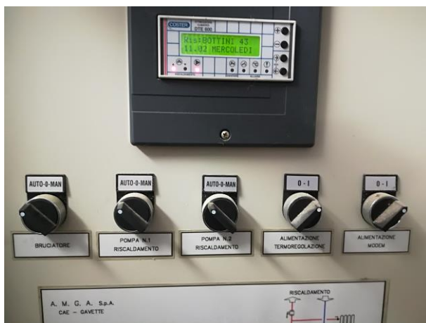
Figura 4.5 - Particolare del pannello di controllo di dell’impianto termico 1
