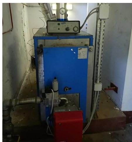
Figura 8.7 - Particolare del generatore di calore attuale
