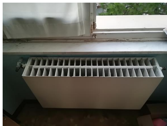
Figura 4.4 - Particolare dei radiatori installati sulle pareti esterne degli ambienti
