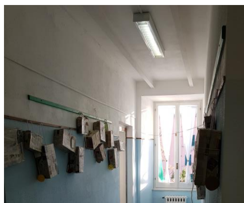
Figura 4.11 - Particolare dei corpi illuminanti ubicati nei locali dell'edificio
