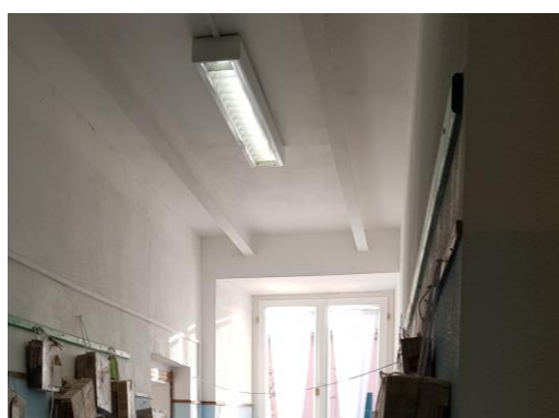
Figura 8.9 - Particolare di una lampada fluorescente attualmente installata
